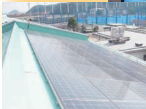
校舎屋根に設置した太陽光パネル
