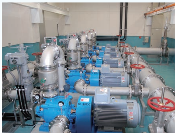
小瀬水源の送水ポンプ
