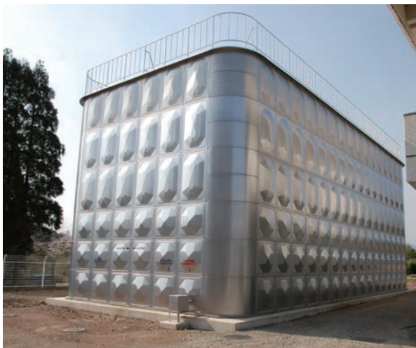
小瀬水源受水槽
