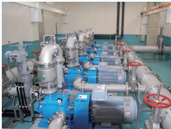
小瀬水源の送水ポンプ
