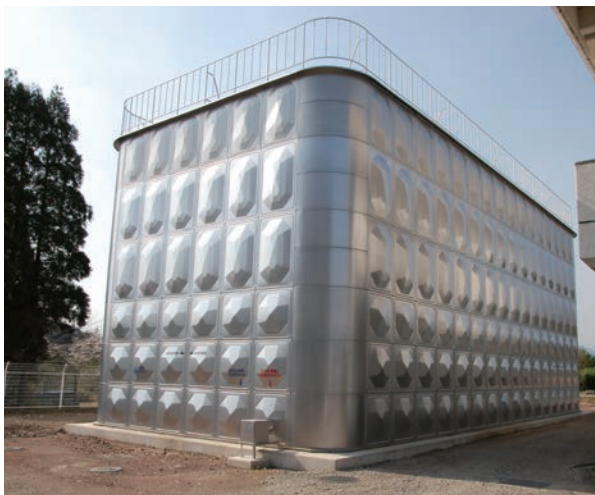
小瀬水源受水槽
