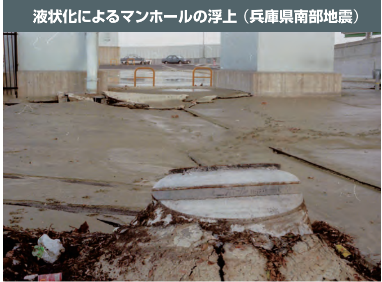
液状化によるマンホールの浮上(兵庫県南部地震) 提供元：埼玉大学 谷川尚氏 出 典：地震本部ウェブサイト https://www.jishin.go.jp/
