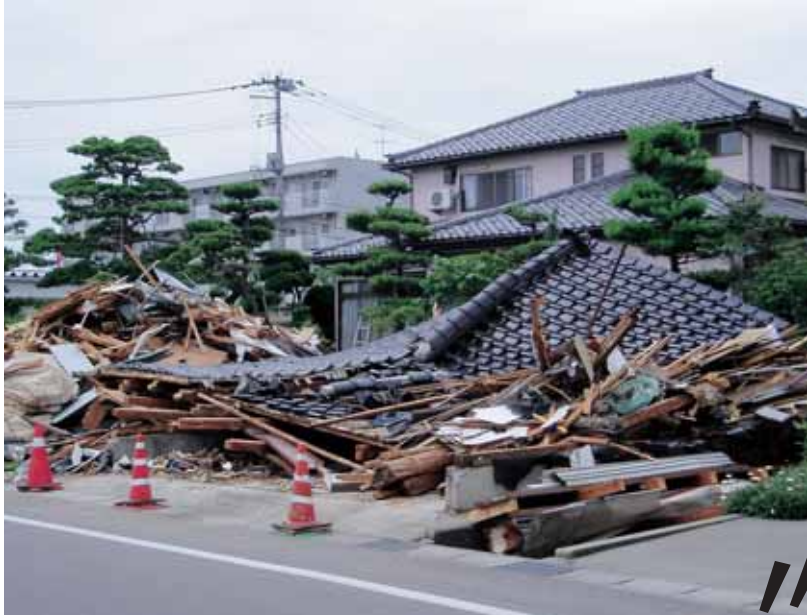
▲新潟県中越沖地震での被害（19年7月25日撮影）
