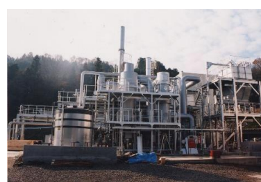
30t焼却炉 焼却炉(平成8年完成)
