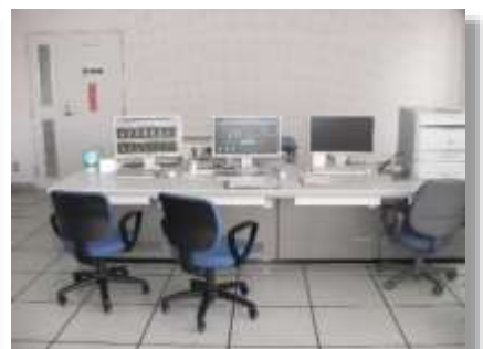
監視室の様子
