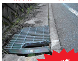
道路側溝の蓋の破損
