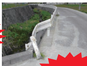
ガードレールの破損
