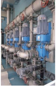
(1) 小瀬水源地 (送水ポンプ)
