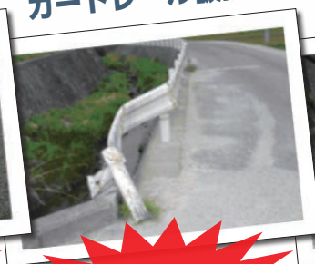
ガードレール破損
