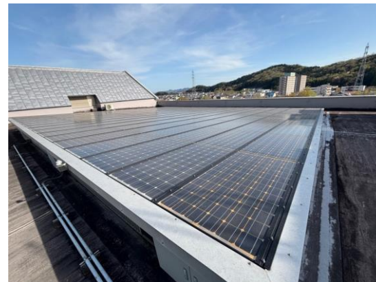
図6-5 市役所（議会棟）に設置されている太陽光発電設備
