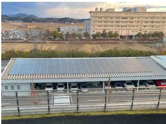
図6-4 市役所（車庫棟）に設置されている太陽光発電設備
