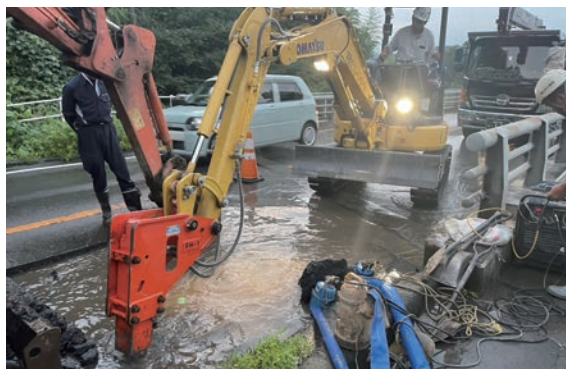
令和6年9月庄中橋南端で漏水事故
