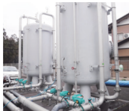
安全で安心な水道水をお届けするため 活性炭ろ過機を導入しました。
