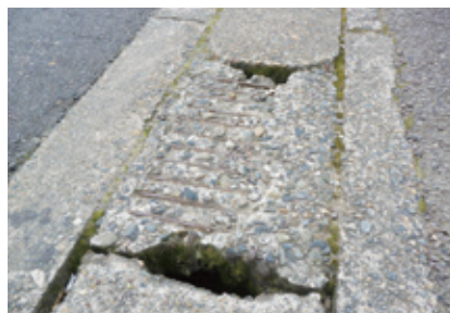
側溝蓋の破損写真
