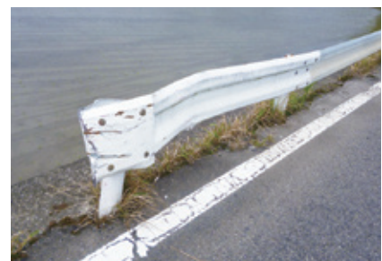
ガードレール破損写真
