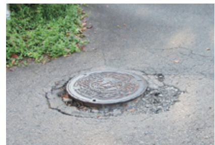
マンホールの段差
