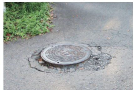
マンホールの段差
