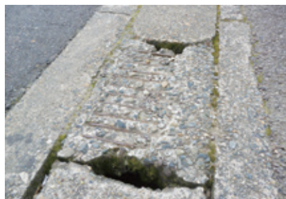
側溝蓋の破損写真
