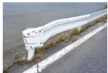
ガードレール破損写真
