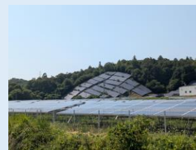
太陽光発電設備の設置例
